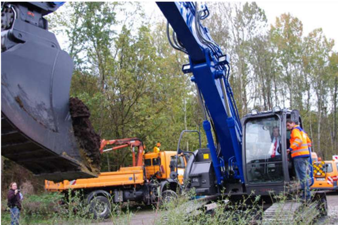
Enak Ferlemann, Parlamentarischer Staatssekretär beim Bundesministerium für Verkehr, Bau und Stadtentwicklung beim Spatenstich mit Bagger. (Foto: Tim Stobbe)
