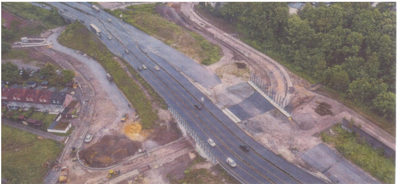
Die Schlüsselstelle der Querspange, eine Art Weiche: Dort wird die A448 mit dem Nordhausenring verschmelzen. Links unten im Bild beginnt die neue Steinkuhlstraße; sie verläuft nach rechts unter der A448 her. Darüber links im Bild die frühere Steinkuhlstraße, die zur Spielstraße wird. FOTO: INGO OTTO
