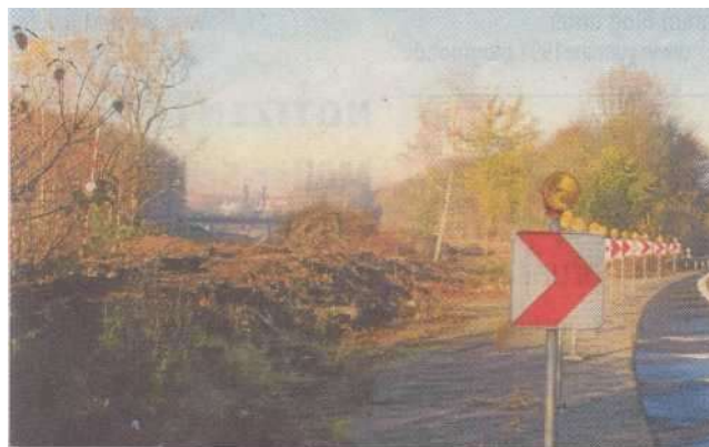
Auch an Auf- und Abfahrt zur A44 sind die Spuren der vorbereitenden Arbeiten für den Bau der Opel-Querspange nicht zu übersehen. RN-Foto Koers (A)
