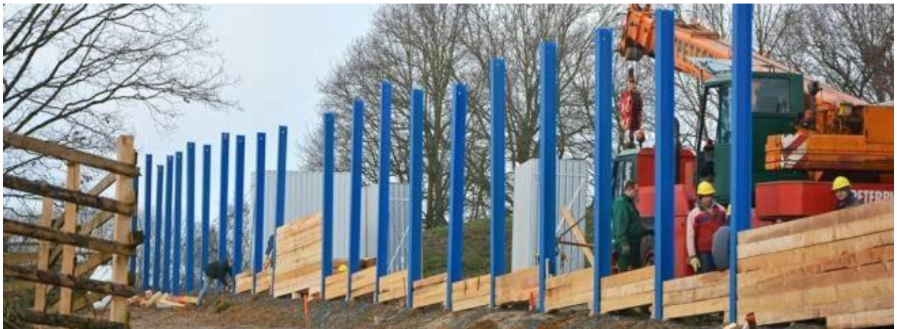
Arbeiter ziehen derzeit eine provisorische blaue Lärmschutzwand an der Höfestraße hoch. Foto: Gero Helm
