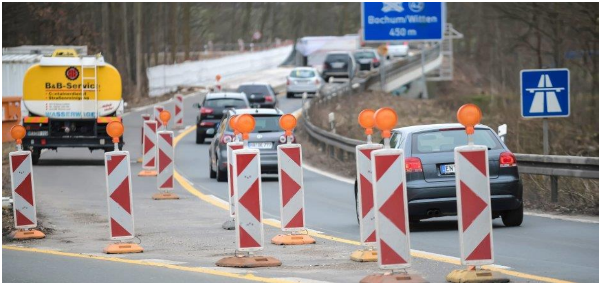
Diese Verbindungsrampe an der Wittener Straße ist ab heute gesperrt. Sie führt über die neue Querspange. Die Gegenrichtung aus Richtung Witten bleibt geöffnet. Foto: Ingo Otto
